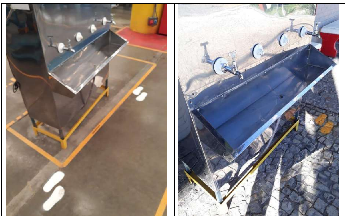
BEBEDOUROS COM TORNEIRAS SUBSTITUIDAS PARA IMPEDIR QUE SE BEBA ÁGUA DIRETO NESTE EQUIPAMENTO
