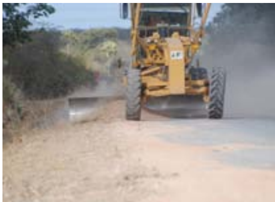
A nova estrada do Bonfim está sendo construída com recursos da Prefeitura de Sobral e do Governo do Estado
